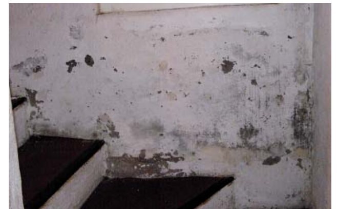
Feuchteschäden bei Kellertreppe.
