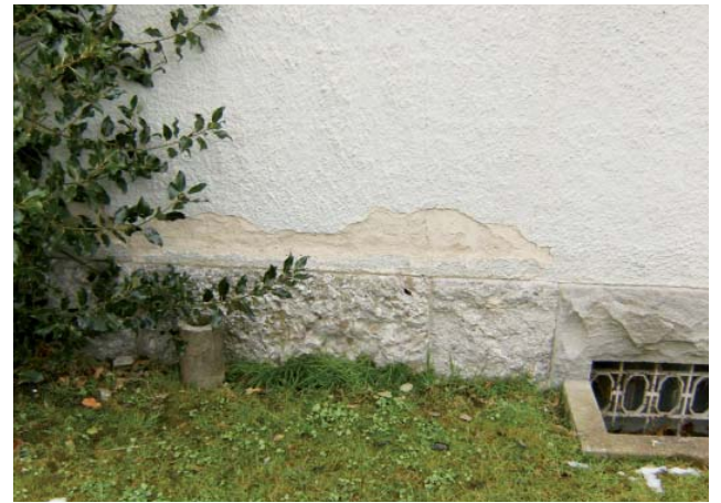
Fassadenschäden durch aufsteigende Feuchte.
