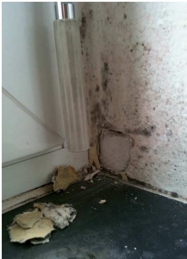
Schimmelecke bei Fenster.
