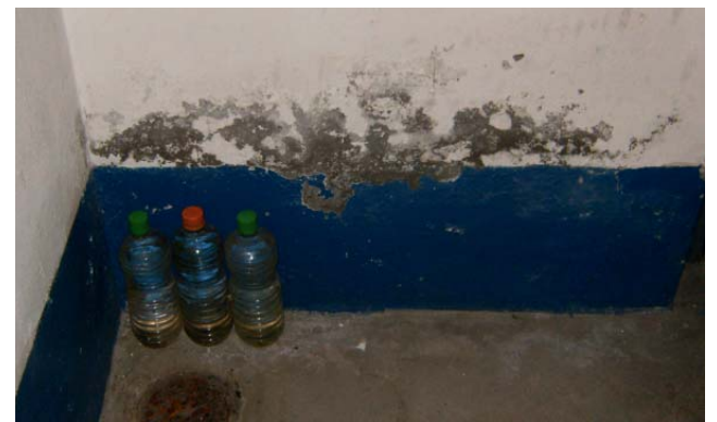
Putzschäden wegen Versalzung.
