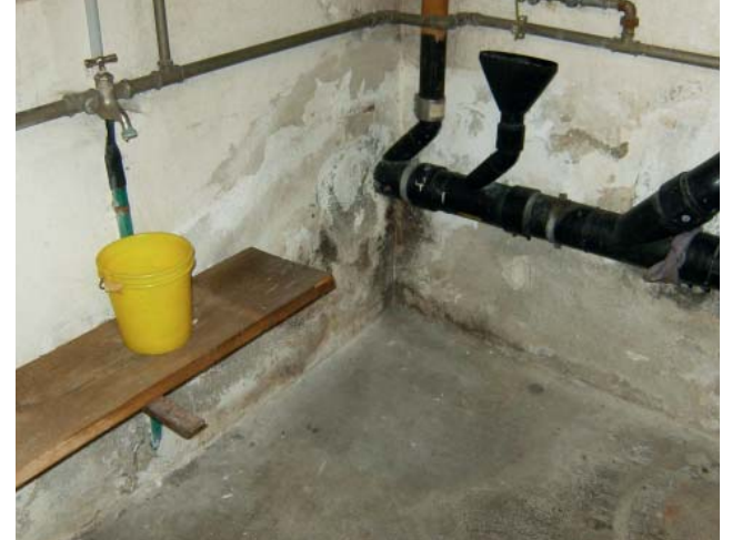
Feuchte Ecke mit Schimmel in der Waschküche.
