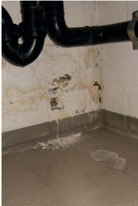
Starker Feuchtschaden im Keller.
