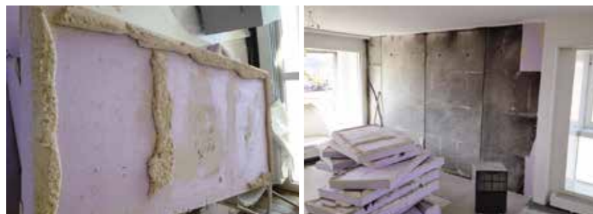
Ist die Bausubstanz von Schimmelbefall betroffen, kann die Sanierung schnell sehr aufwendig und teuer werden. Deshalb gilt es, möglichst früh zu reagieren.
